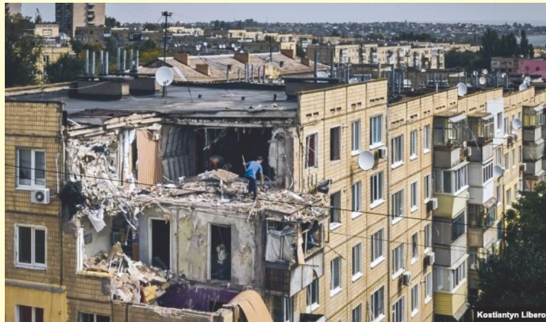
Будинок у Нікополі, зруйнований російськими обстрілами, серпень 2022 (джерело: radiosvoboda.org/a/novyny-pryazovya-nikopol-na-liniyi-vohnyu-intervyu-yevtushenko/32825549.html )
