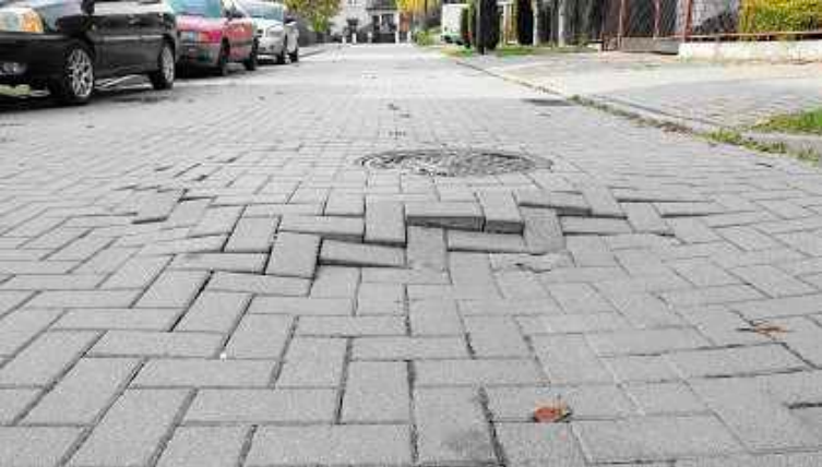
Zapadnięta kostka wciąż czeka na naprawę
