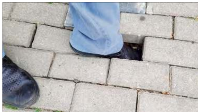
Dziura w chodniku na ul. Prudnickiej w Krapkowicach.
