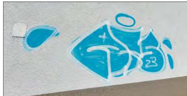
Wątpliwej jakości „dzieło artystyczne” pojawiło się na tylnej ścianie obiektu.
