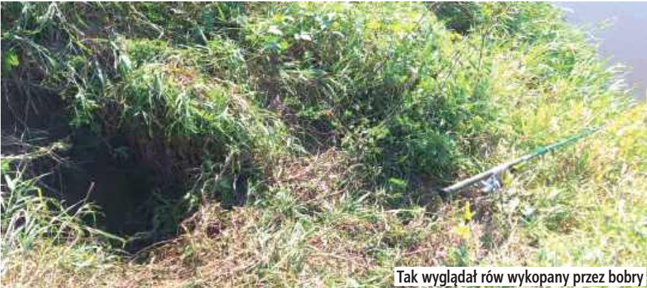
Tak wyglądał rów wykopany przez bobry
