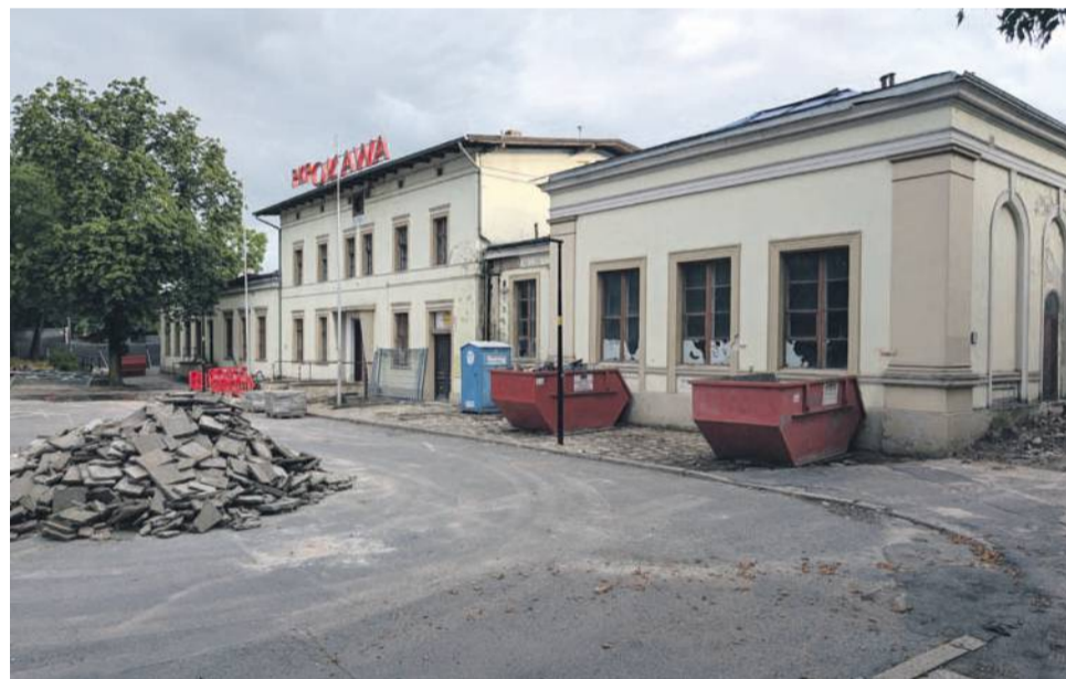
Tu już nie ma wejścia
