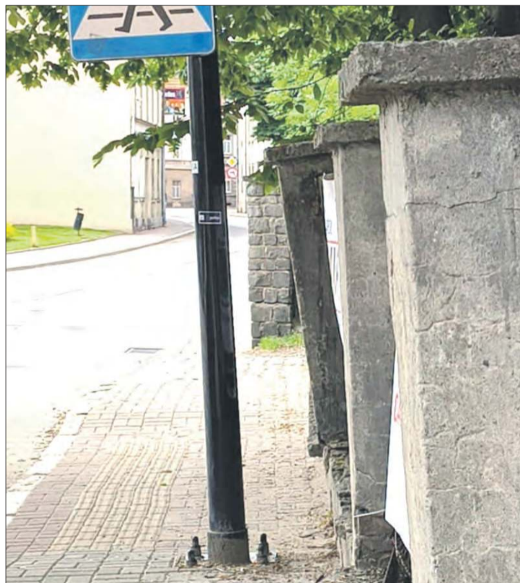
Ogrodzenie na skrzyżowaniu ulic Batorego i Armii Krajowej naprzeciw jednego w mieście (!) sklepu rybnego. Murek dosłownie jakby chciał upaść na przechodniów. Może należy do posesji prywatnej, ale ze strony miasta ktoś powinien dbać, aby takie miejsca nie zagrażały mieszkańcom i nakazać remont zarządcy obiektu – pisze czytelniczka. (z)
