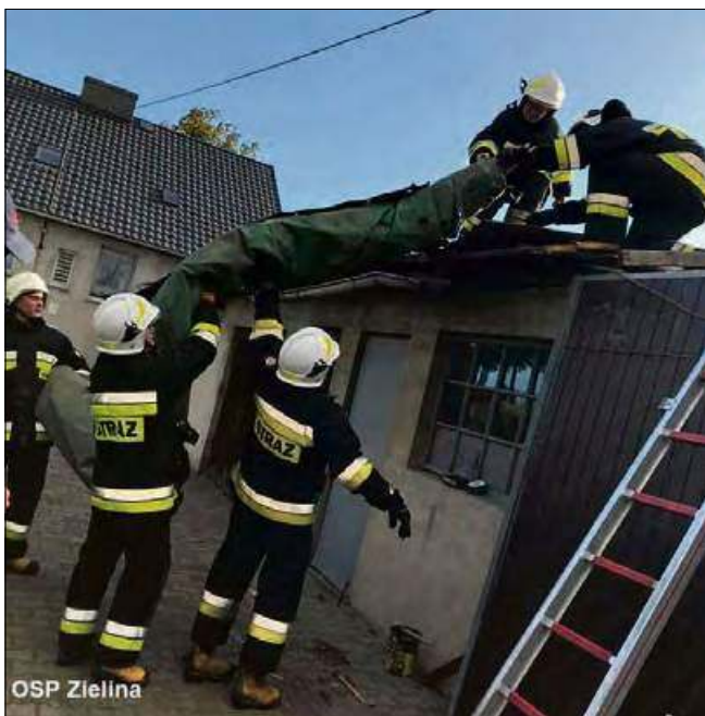
W Zielinie z jednego z garaży został zarwany dach.
