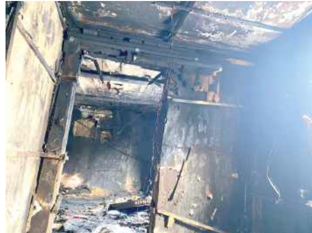
Dom został poważnie uszkodzony i w obecnym stanie nie nadaje się do zamieszkania. W jednej chwili jego mieszkańcy stracili dach nad głową, cały dobytek i poczucie bezpieczeństwa, które buduje się latami
