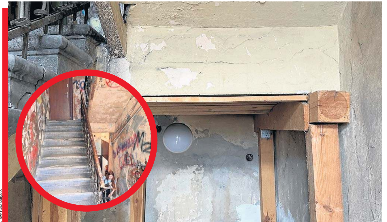
Tak wygląda klatka schodowa w kamienicy przy ul. Limanowskiego 13. Stropy podparto drewnianymi belkami.
