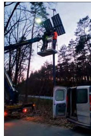
Oświetlenie wyróżnia się nowoczesnymi rozwiązaniami technicznymi.
