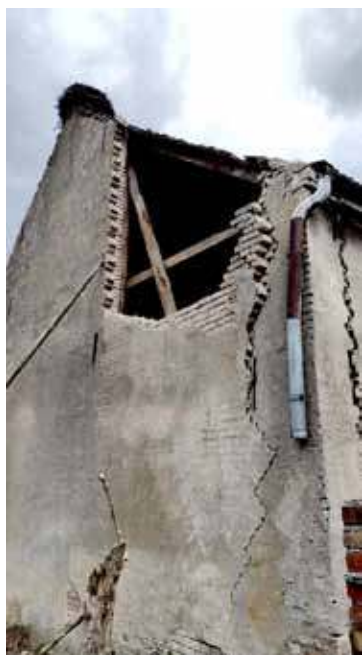
Strażacy z Marianowa zostali zadysponowani do uszkodzonej ściany szczytowej stodoły w miejscowości Wiechowo. Foto. OSP. Marianowo
