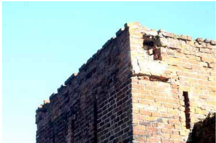
Degradacja widoczna jest w wielu miejscach. Tu dla przykładu zaczynają odpadać cegły
