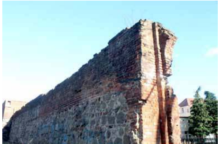
Widoczne u góry wyszczerbienia murów to też częsty widok
