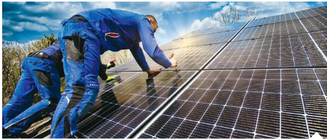
Właściciel paneli powinien regularnie kontrolować stan instalacji, a także zwracać uwagę na wszelkie anomalie w jej pracy | fot. AdobeStock/d
