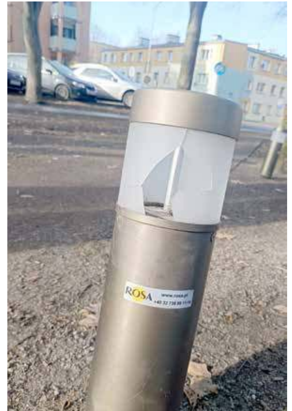
Nie wszystkie uszkodzenia są oznaczone
