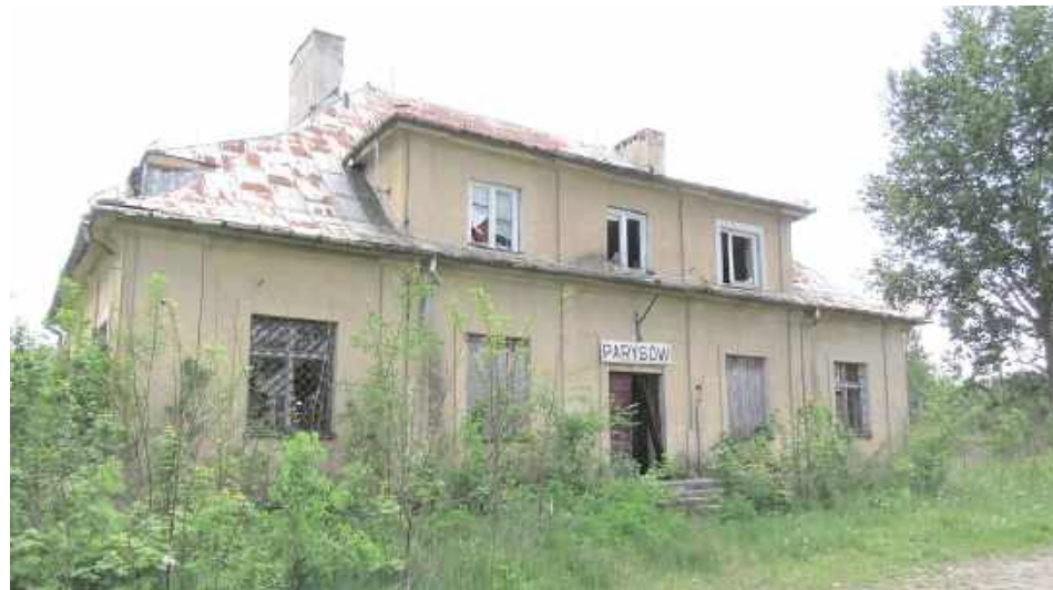
Zdewastowany budynek stacyjny, widok od strony ulicy (maj 2025)
