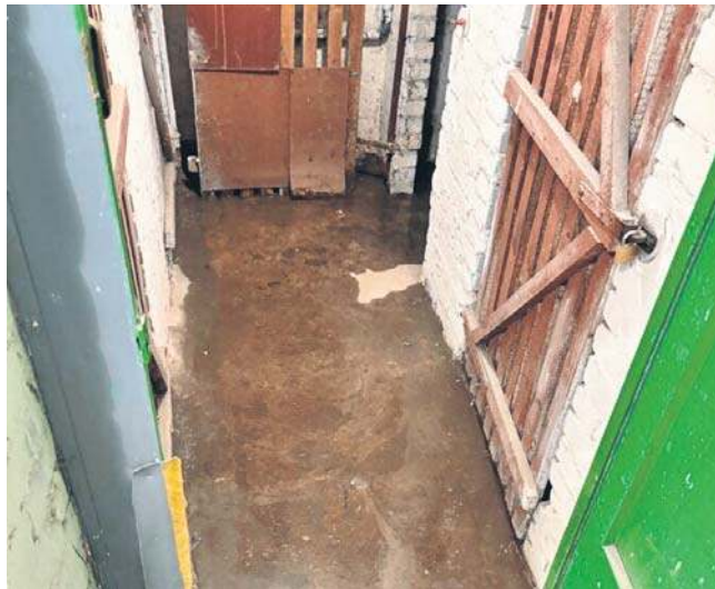
Zalana piwnica w budynku przy ul. Koszalińskiej
