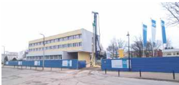
Przebudowa sądu w Puławach ruszyła jesienią. Ciężki sprzęt budowlany i ciężarówki wyjeżdżające z placu budowy to teraz tam częsty widok
