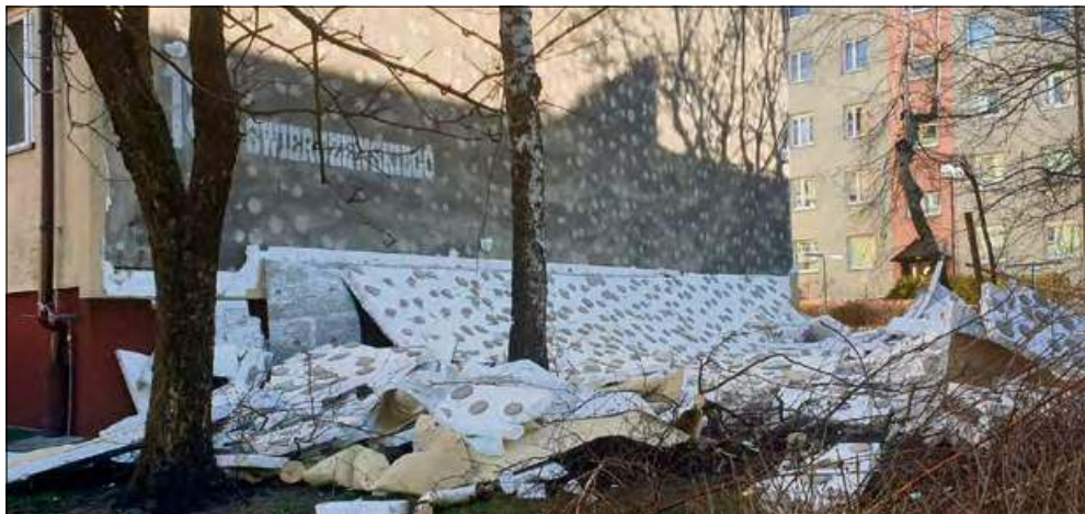
Izolacja spadła wraz z tynkiem z wysokości czwartego i trzeciego piętra.
