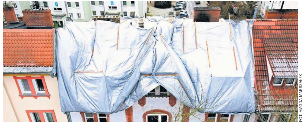
Umowa na remont spalonego dachu ma zostać podpisana w przyszłym tygodniu
