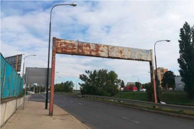
Zardzewiałe bramownice już nie straszą na Tatarach
