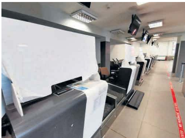
W punktach odprawy bagażowo-biletowej oraz lotniskowej informacji zamontowano ścianki z pleksi
