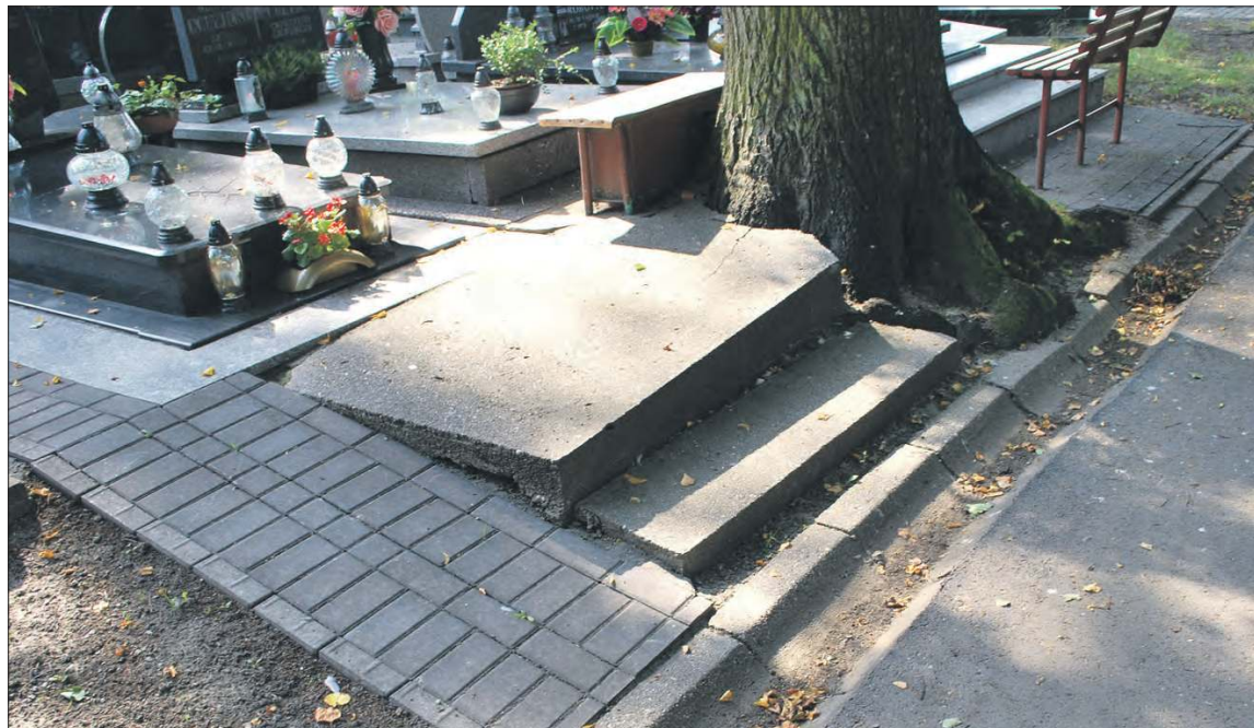
Betonoza przy głównej alei
