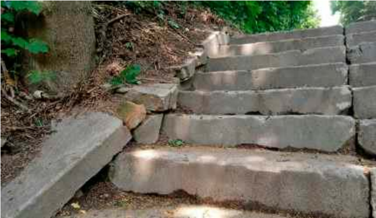
Schody z ul. Kosmowskiej na tzw. Stary Czechów zostaną wyremontowane, o ile znajdzie się firma zainteresowana tym zleceniem
