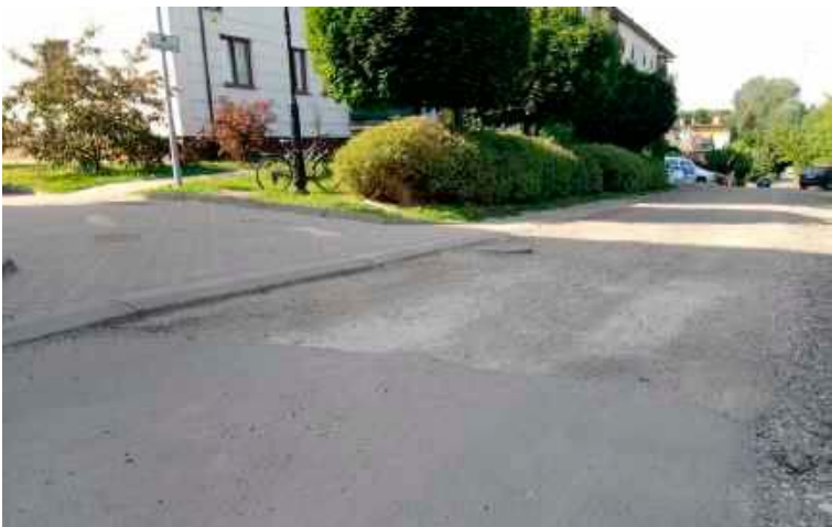
Szutrowa przerwa między odcinkami nowo położonego asfaltu prawdopodobnie zostanie na lata
