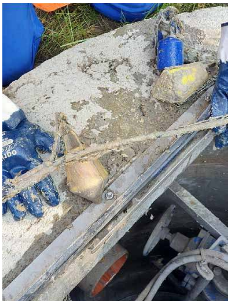
Zanieczyszczony czujnik pompy
