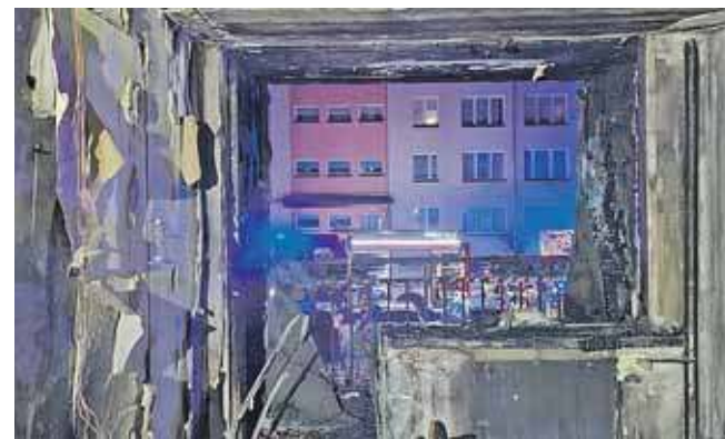
Pożar wybuchł w jednym mieszkaniu w bloku w Strzybnicy
