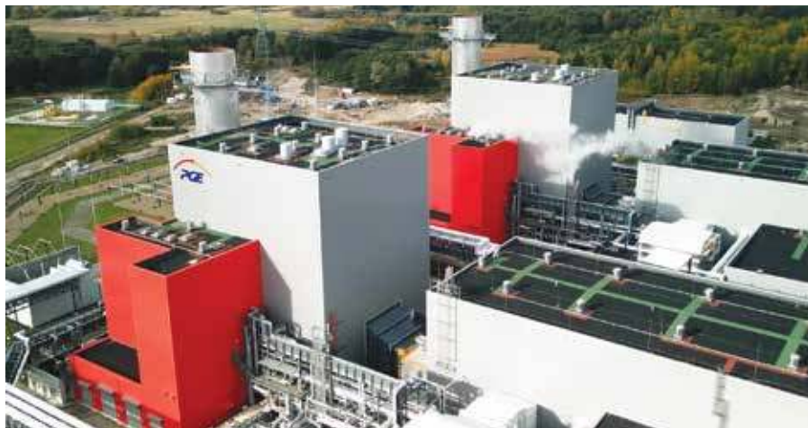
Elektrownia gazowa PGE Gryfino Dolna Odra
