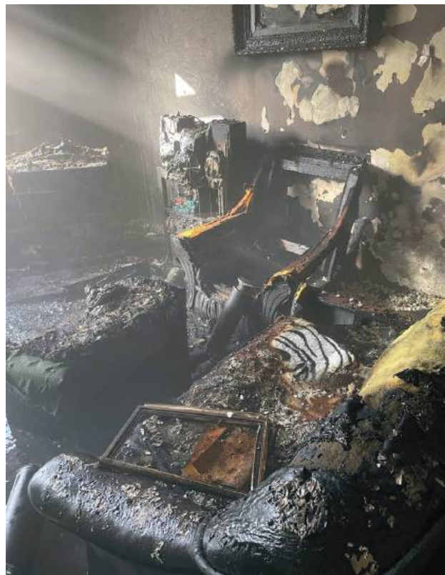
Wypalone wnętrze domu w szeregowcu przy ul. Księżycowej w Łęcznej
