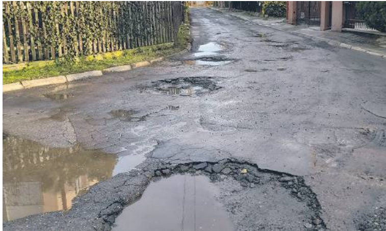
O odszkodowanie występowali m.in. kierowcy, którzy auto uszkodzili na dziurach na ul. Baczyńskiego
