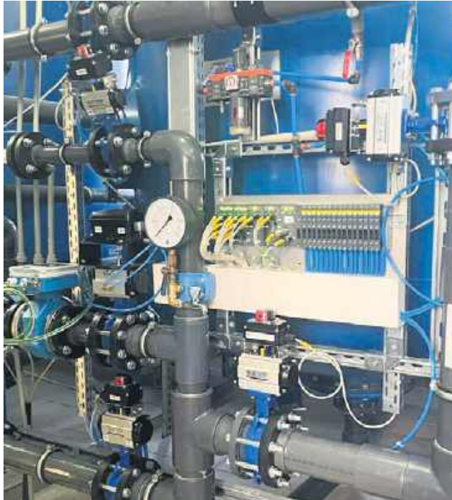
Stacja uzdatniania wody w Zakrzewie
