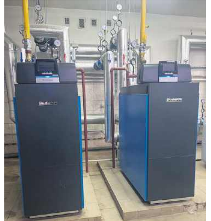
Kotły w budynku Publicznej Szkoły Podstawowej w Zakrzewie
