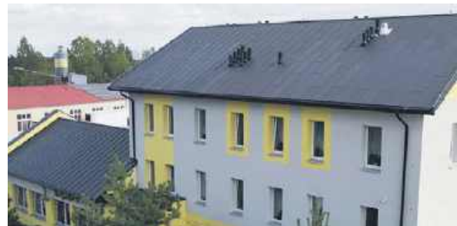
Dach fotowoltaiczny na budynku ZPRS w Goździkowie
