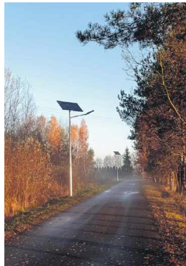
Energooszczędne, solarne oświetlenie uliczne.
