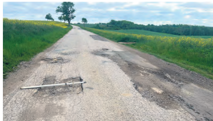
Tak wyglądał jeden z gorszych odcinków drogi 1038C w kierunku Minikowa. Obecnie drogowcy naprawiają naważne fragmenty traktu, o którego remoncie w całości zabiegają jego użytkownicy. Fot. nadesłane
