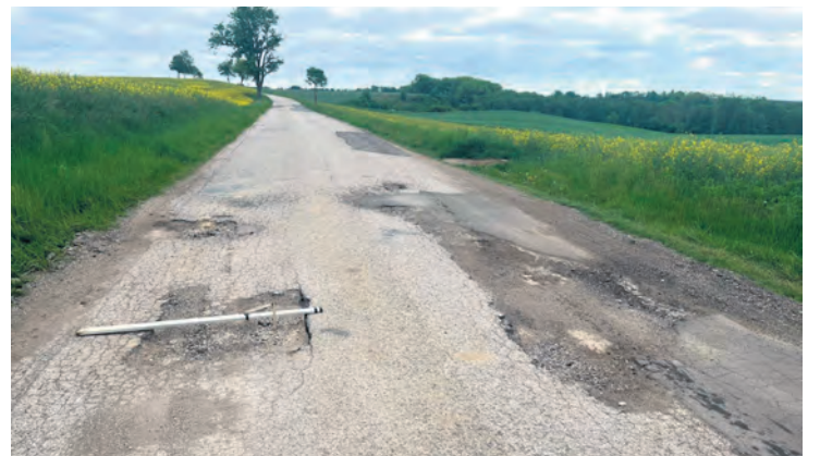
Tak wyglądał jeden z gorszych odcinków drogi 1038C w kierunku Minikowa. Obecnie drogowcy naprawiają naważne fragmenty traktu, o którego remoncie w całości zabiegają jego użytkownicy. Fot. nadesłane
