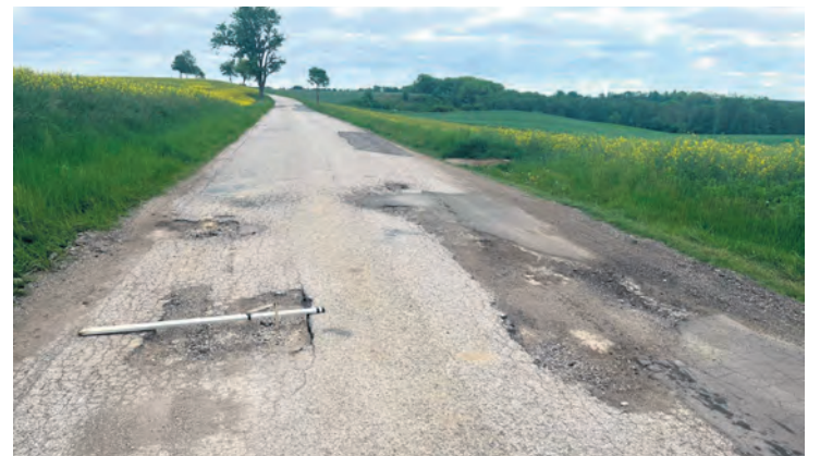
Tak wyglądał jeden z gorszych odcinków drogi 1038C w kierunku Minikowa. Obecnie drogowcy naprawiają nawałne fragmenty traktu, o którego remoncie w całości zabiegają jego użytkownicy. Fot. nadesłane
