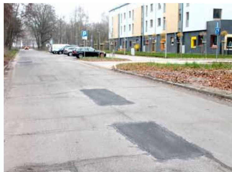
Świeże wypełnienia na Śniadeckiego wskazują, że dziury zostały załatwane
