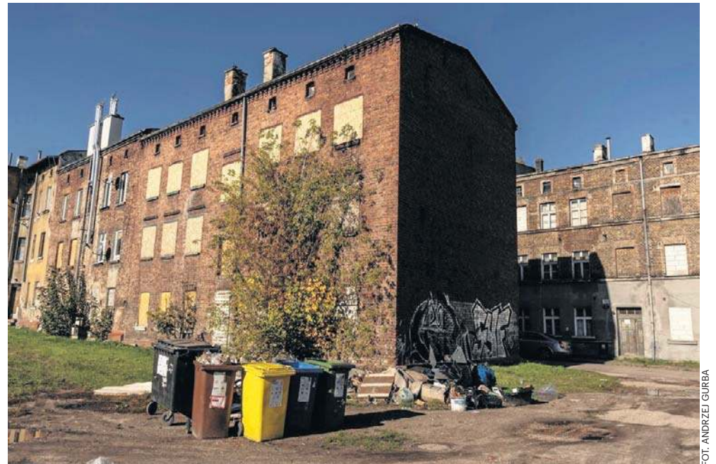
Przy ul. Przy Torze więcej jest pustostanów, niż lokatorów. Plan remontowy Gdańska są mgliste, a na wyburzenie budynków nie zgadza się konserwator zabytków
