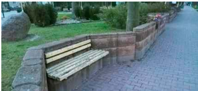
Urzędnicy zapewniają, że ławki niebawem odzyskają blask. Być może uda się również wyremontować murek
