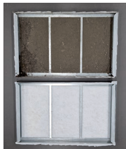
Fot. 1. Zanieczyszczony oraz czysty filtr kanałowy Źródło: własne autora
