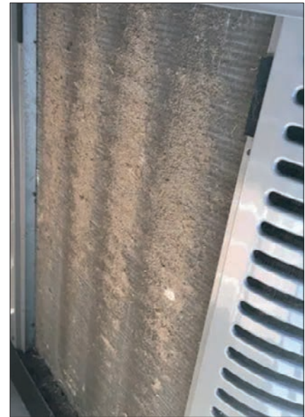
Fot. 4. Widok zanieczyszczonego wymiennika ciepła
