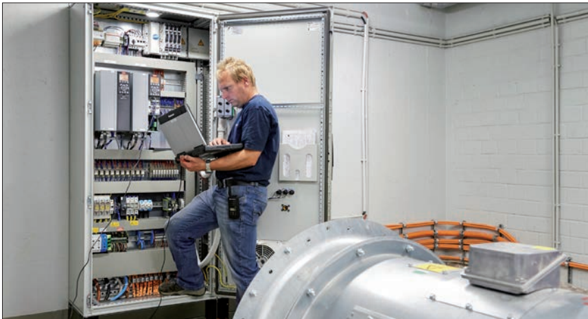
Rys. 3. Centrala zasilająco-sterująca wentylacją pożarową z przemiennikami częstotliwości Źródło: Systemair
