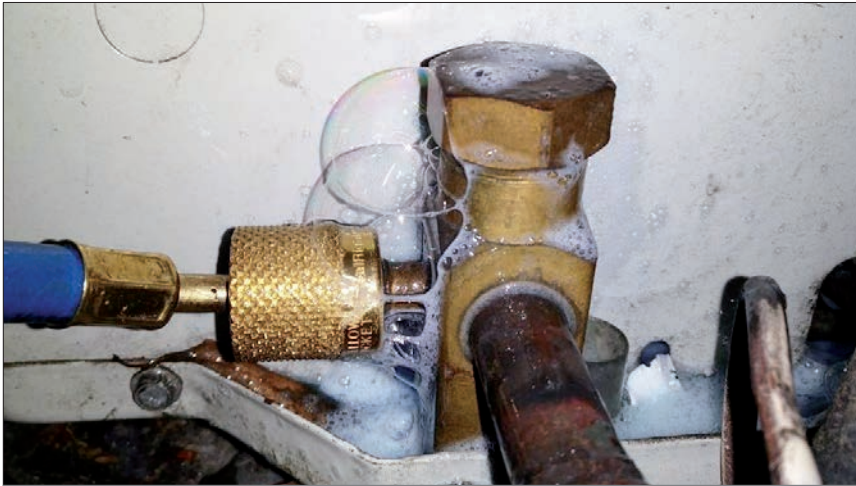
Fot. 2. Poszukiwanie i lokalizowanie nieszczelności
