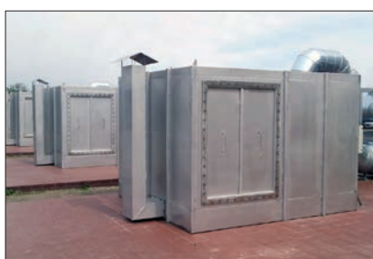
Fot. 1. Instalacja filtracji odorów zastosowana w oczyszczalni ścieków Kraków-Płaszów Źródło: Zakład Doświadczalny Produkcji Węgla Aktywnych
