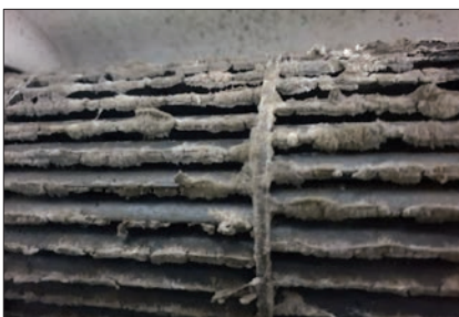
Fot. 3. Widok znacznego zanieczyszczenia i powstania osadu na turbinie wentylatora
