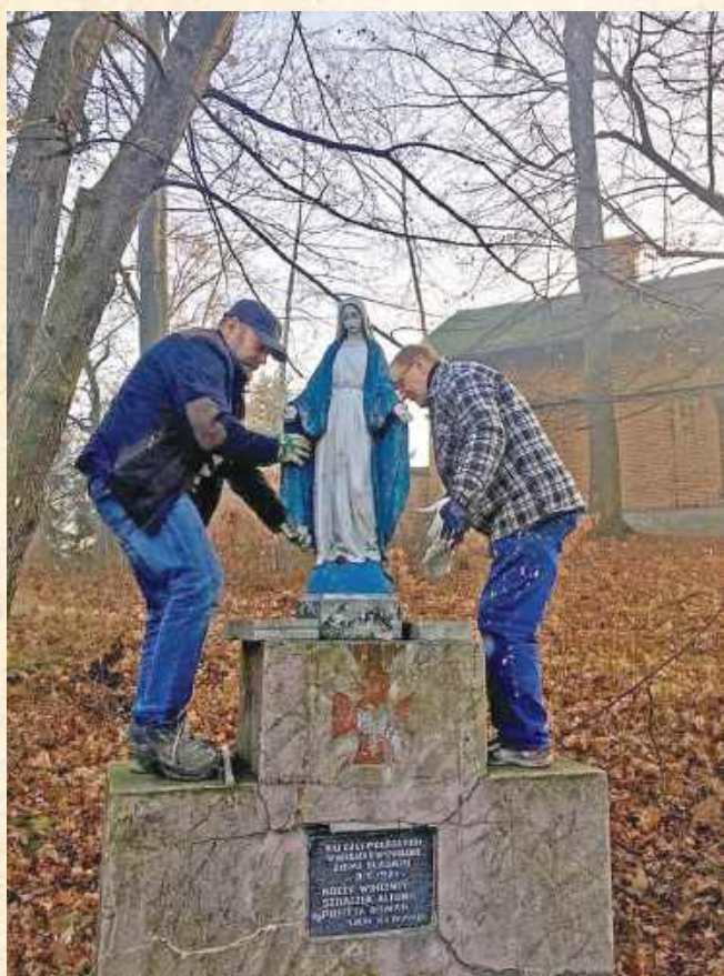
■ Pomnik wymagał renowacji. Pęknięcia cokołu i uszkodzenia figury sprawiły, że konieczne było odtworzenie brakujących elementów oraz odnowienie całości. FOT. FUNDACJA NA RZECZ OCHRONY DÓBR KULTURY
