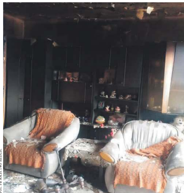
Mieszkanie pani Eugenii zniszczone po pożarze
