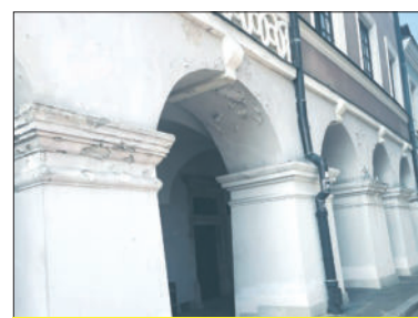
Miasto ogłosiło przetarg na wykonawcę renowacji podcieni kamienic przy ul. Staszica. Fot. her
