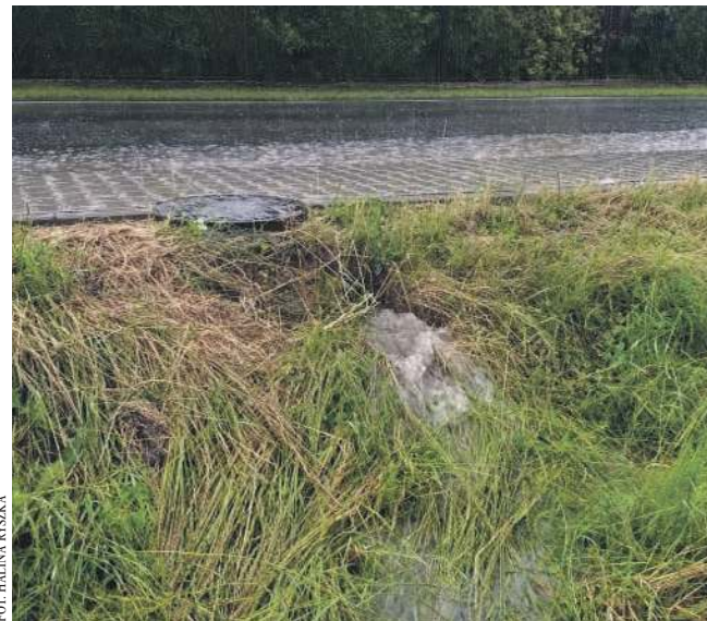
Podczas ulew woda wypływa ze studni chłonnej
