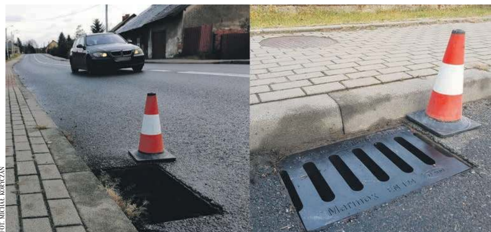
W miejsce skradzionych kratk żeliwnych zamontowane zostały polimerobetonowe
