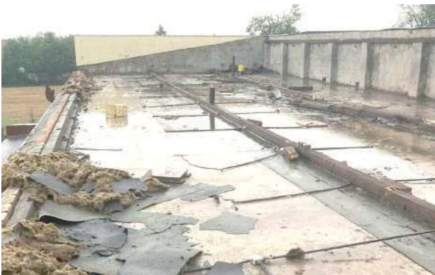
Niestety burza zabrała cały dach z kościoła w Siemieniu
