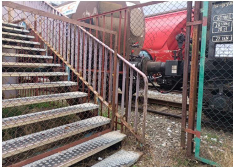
Dziura w siatce ogrodzeniowej zaprasza do niebezpiecznego przejścia torami.
