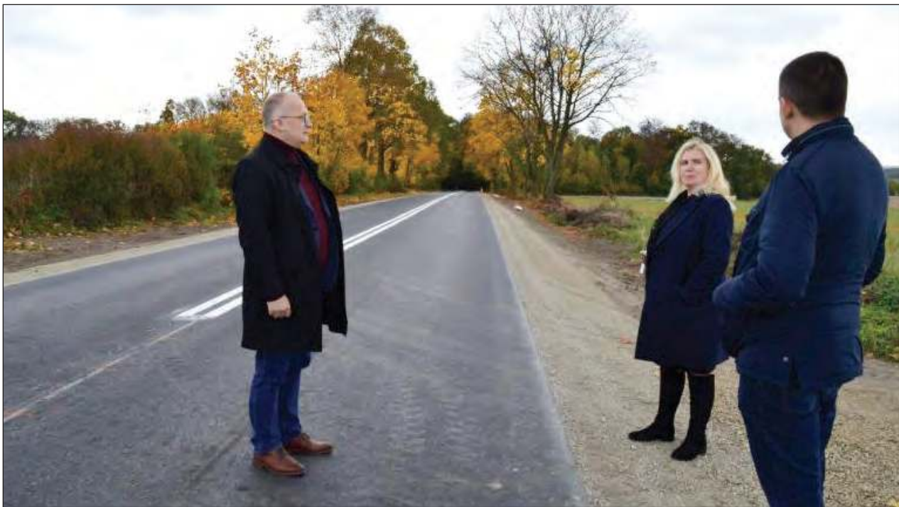
Przebudowa drogi dobiega końca. Zadowolona z przeprowadzonej inwestycji nie kryją starosta rycki Dariusz Szczygiel-ski, wójt Ułęża Barbara Pawlak i dyrektor ZDP w Rykach Marcin Kostyra
