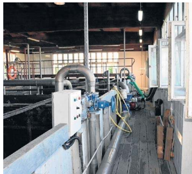
Stare Pole musi zmodernizować swoją oczyszczalnię ścieków, lipcowa ulewa to potwierdziła
