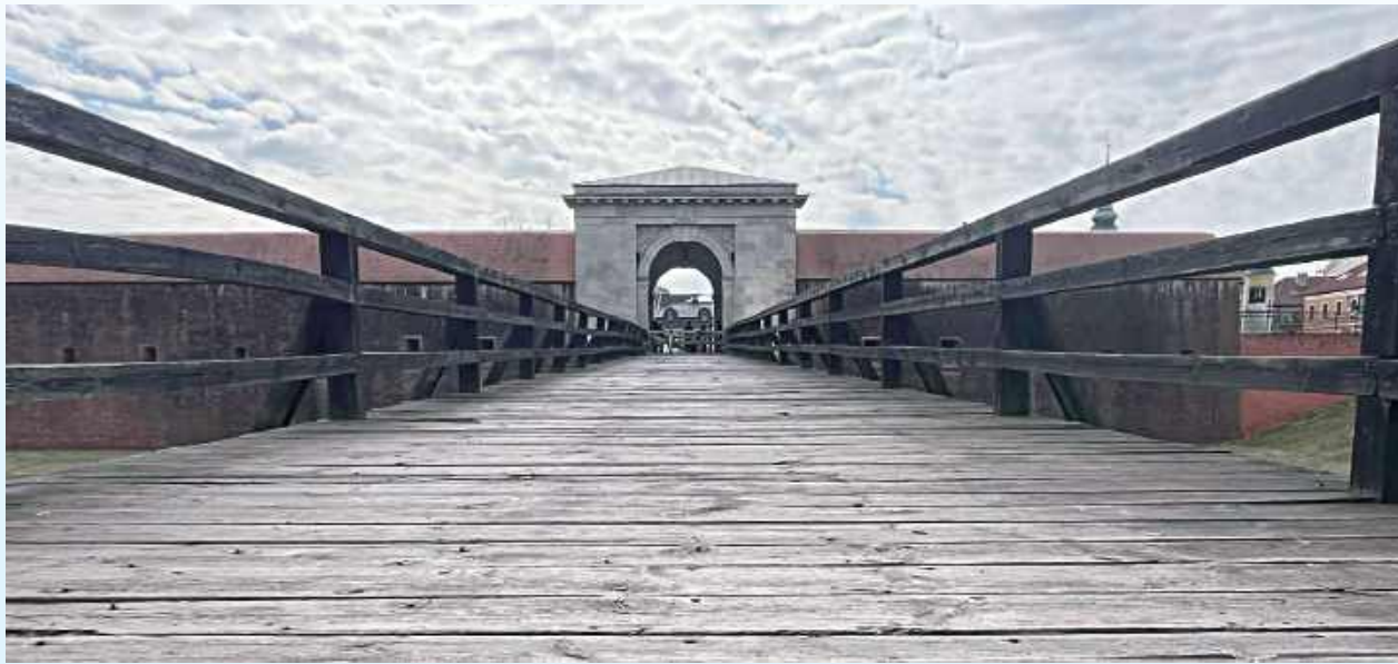
Co dalej z remontem mostu przy Nowej Bramie Lubelskiej w Zamościu?
