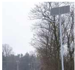
Zadanie pn. „Budowa oświetlenia zasilanego zieloną energią na terenie Gminy Trojanów” współfinansowano ze środków Samorządu Województwa Mazowieckiego
