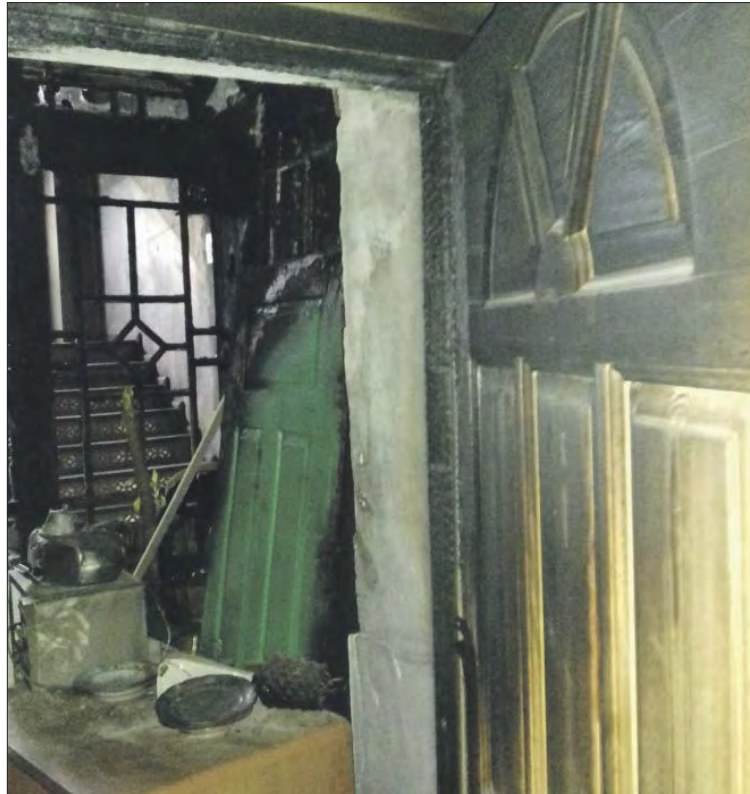
Mieszkanie zniszczone w wyniku pożaru
