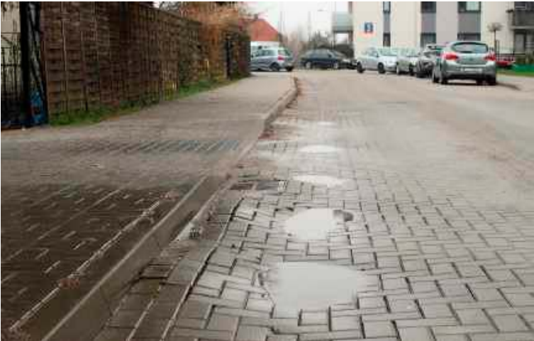
Zdaniem mieszkańców i radnej M. Suchanowskiej takie uszkodzenia ulicy Jemiołowej powstały z winy dewelopera
