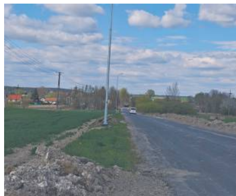
Wola Siennicka - modernizacja oświetlenia ulicznego.
