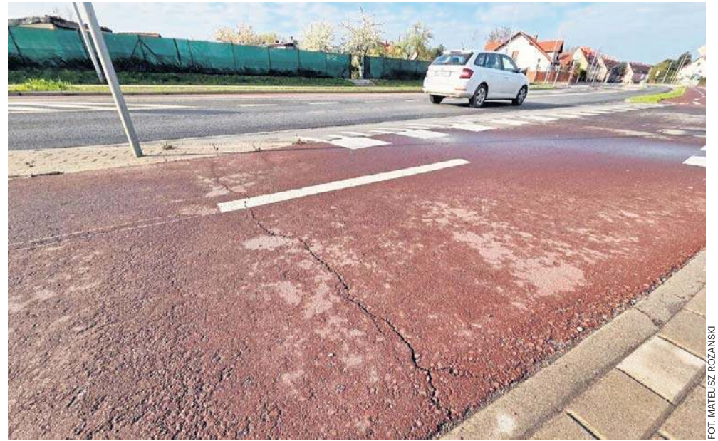
Zimy nie wytrzymała ścieżka rowerowa - pojawiły się spore pęknięcia
