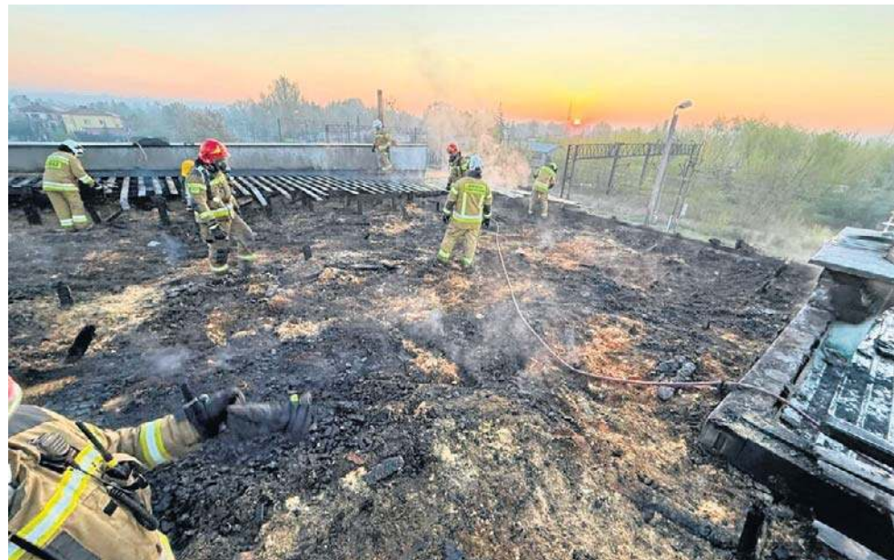
Do pożaru doszło na dachu hotelu przy ulicy Lwowskiej w Sandomierzu. Po ugaszeniu ognia strażacy rozpoczęli prace związane z rozbiórką nadpalonych elementów
